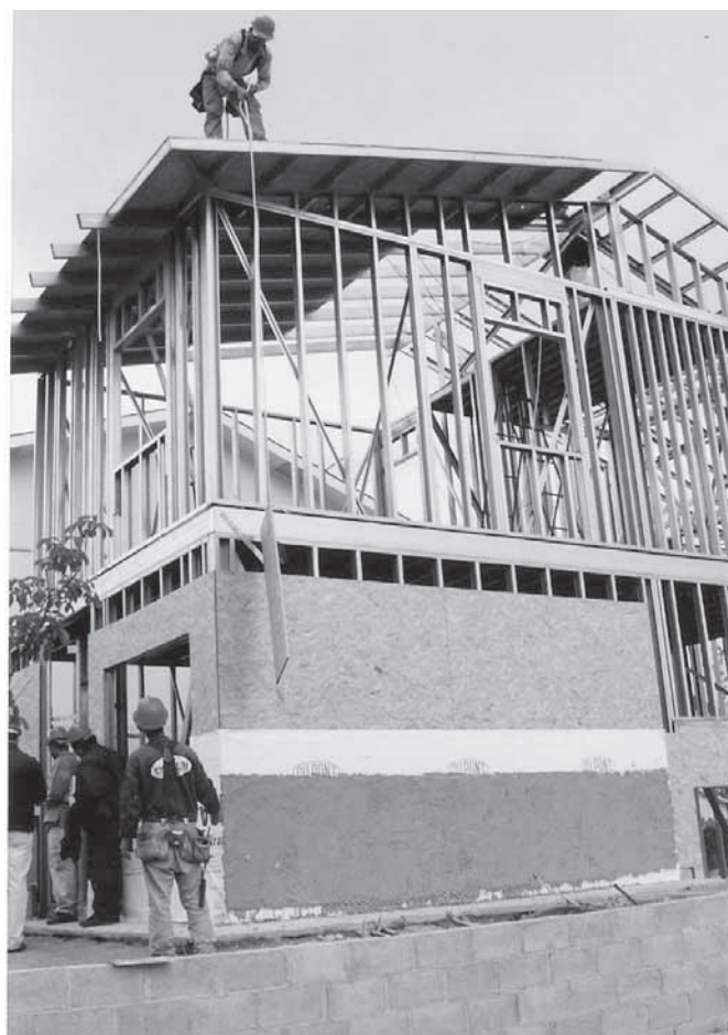
Foto 7.21 – Instalação de placas de OSB sobre o telhado (Fonte: arquivo do autor)
