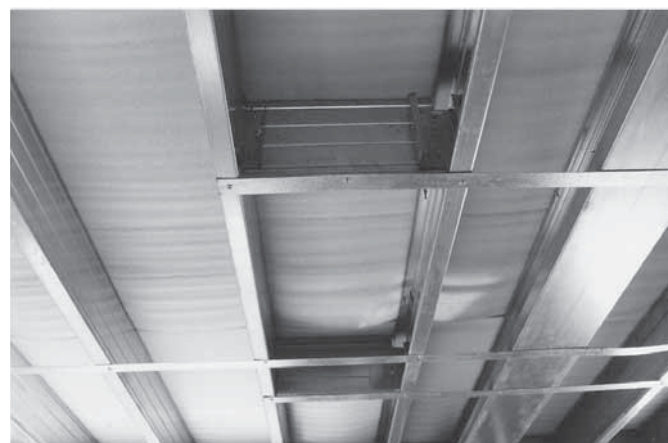
Foto 4.8 - Travamento horizontal da laje de piso por meio de bloqueadores e fitas metálicas (Fonte: arquivo do autor)
