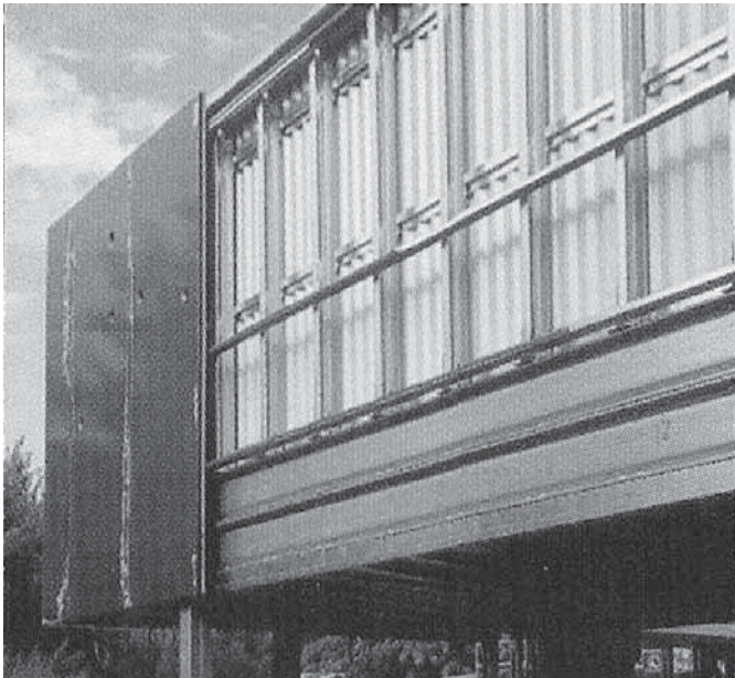
Foto 6.1– Fechamento de edificação em LSF com painéis de aço (Fonte: Revista Architecture à Vivre)
