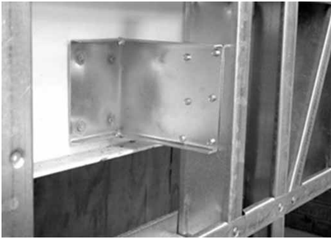
Figura 9.18 – Ligação rígida com insert de abas desiguais e bordas enrijecidas / Fonte: Acervo Flasan, 2011
