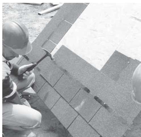
Foto 5.11 – Demonstração de instalação de telhas “shingles” sobre placas de OSB. (Fonte: arquivo do autor)
