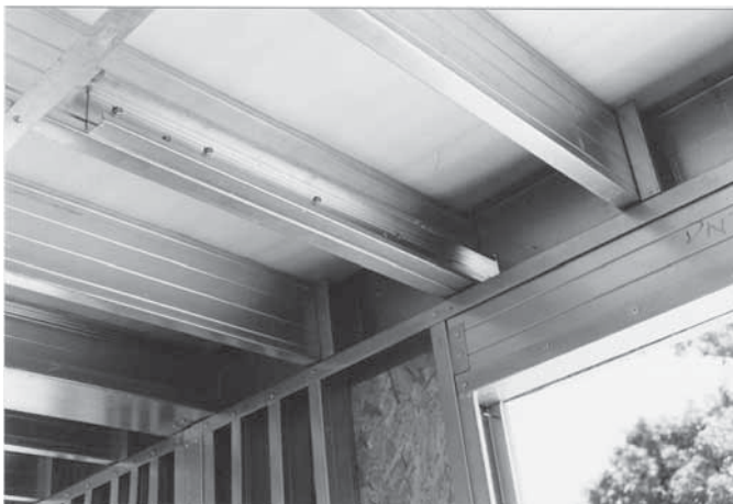
Foto 4.5 - Manta de polietileno expandido entre vigas de piso e contrapiso com placas de OSB. (Fonte: arquivo do autor)
