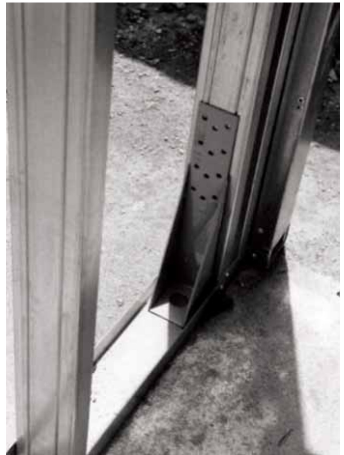
Foto 2.30- Detalhe da peça de reforço na ancoragem da estrutura à fundação por meio de barra rosca. (Fonte: arquivo pessoal)
