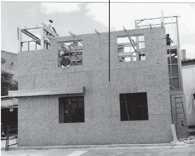
Foto 6.2 – Fachada com fechamento externo em OSB apresentando juntas de dilatação. (Fonte: arquivo do autor)
