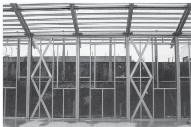
Foto 3.5 - Painéis contraventados em função das aberturas em laboratório na Universidade Federal de Ouro Preto. (Fonte: arquivo Célio Firmo).
