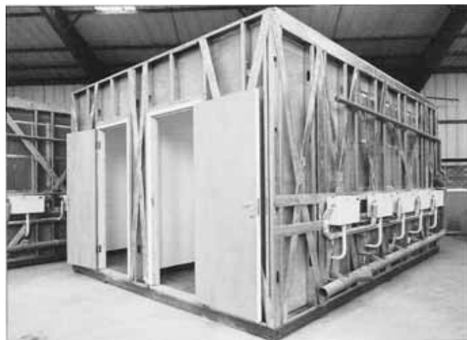
Foto 2.28 - Módulo de banheiro. (Fonte: SCI)
