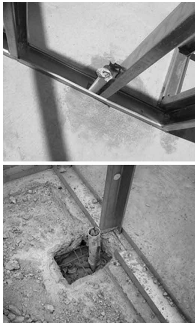
Figura 8.3 – Locação correta dos pontos na fundação e problemas gerados pela locação incorreta Fontes: Acervo Flasan, 2011; SANTIAGO, TERNI, PIANHERI, 2008a
