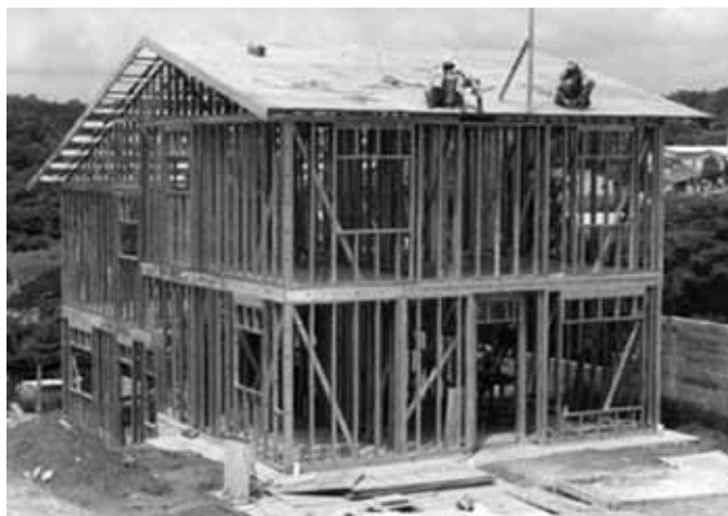
Foto 2.1- Estrutura de residência em Light Steel Framing, São Paulo. (Fonte: Construtora Seqüência)
