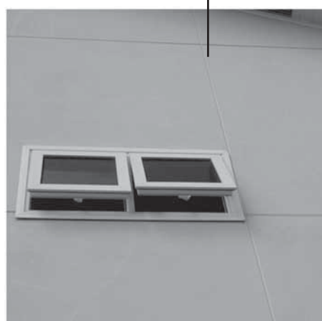
Foto 6.8 - Fachada em OSB revestida com argamassa com juntas aparentes para orientação das trincas. (Fonte: arquivo Célio Firmo)
