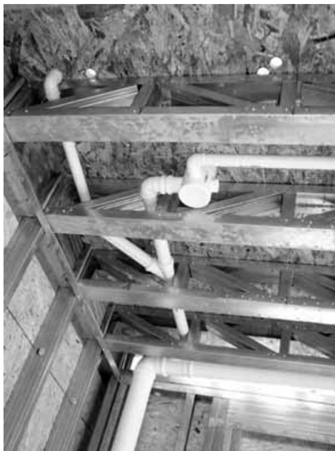
Figura 8.9 – Instalações de esgoto em estrutura de LSF Fonte: Arquiteto Roberto Inaba
